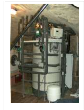
Der Pufferspeicher mit Heizkreismischer und Warmwasserverteilung neben der Wärmepumpe
